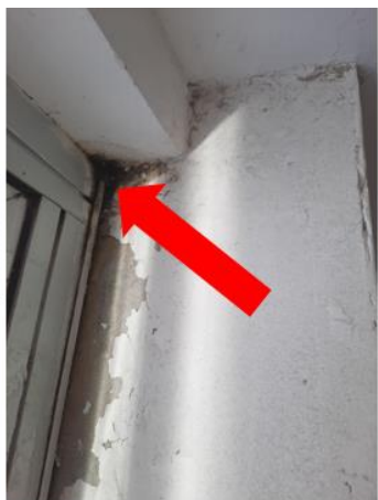
Suciedad en las esquinas de las ventanas.
