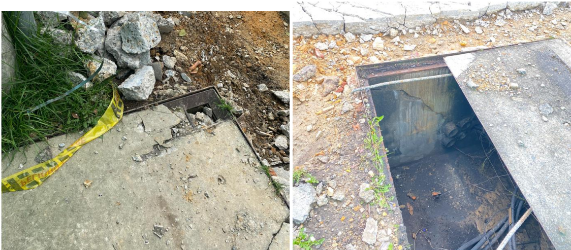
Figura 7. Cajas de inspección de paso
