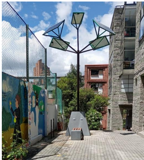
Árbol Solar instalado en la sede Macarena B
